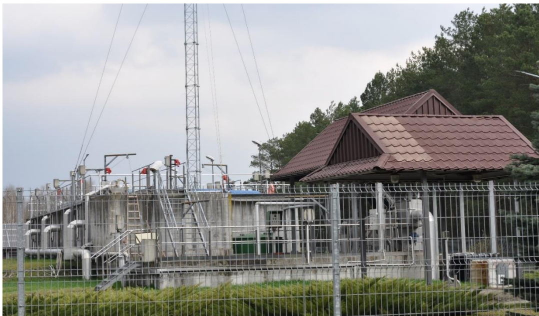
Oczyszczalnia ścieków w Rusinowie
