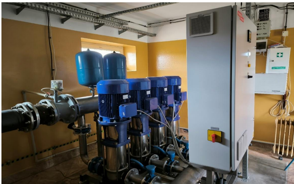
Zestaw hydroforowy w przepompowni wody pitnej w Hucie Komorowskiej
